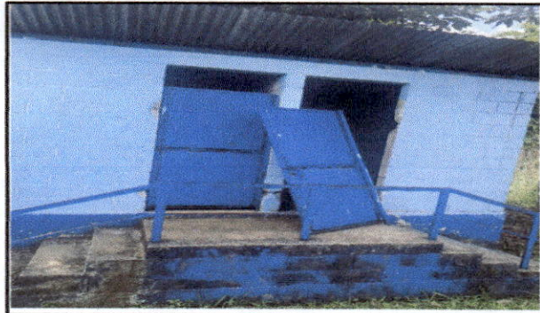
Foto 2: Puertas de sanitarios dañadas.
