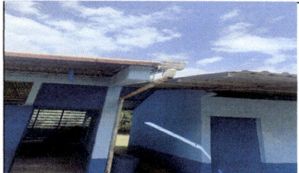
Foto 4: Canal y bajadas de agua en mal estado.
